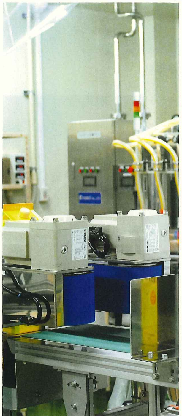
米油を充填するクリーンルーム。窓が大きく、中の作業員が外の様子を見られるため、ストレス軽減に効果がある。
